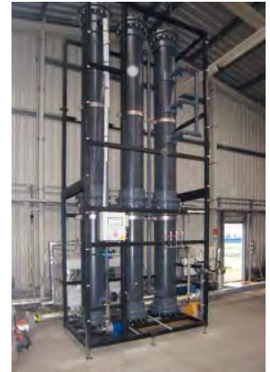
Ozonierungssanlage Ozone columns
