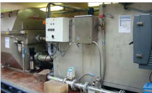
Mikrosiebsanlage Micro sieve installation
