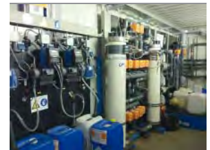
Ultrafiltrationsanlage Ultra filtration unit
